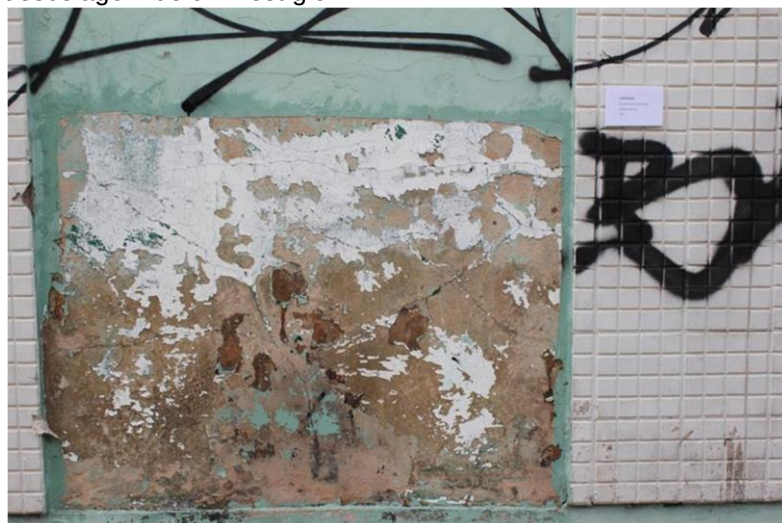
Figura 93 - Exemplo de uma lacuna que ficou na superfície do muro, depois da descolagem de um vestígio
