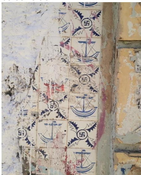
Figura 17 - Fachada de uma parede de azulejo semiencoberta por resíduos de camadas de tintas e argamassa. Zona portuária do bairro do Comércio
