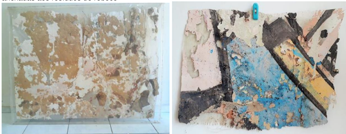
Figura 71 e 72 - Verso de descolagem, onde se vê fragmentos de cascos de paredes anteriores, anexadas aos resíduos de reboco
